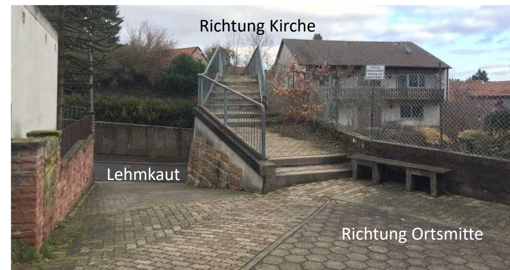
Fußgängerbrücke „An der Lehmkauf“ mit Sanierungs- und Verkehrssicherungsbedarf
