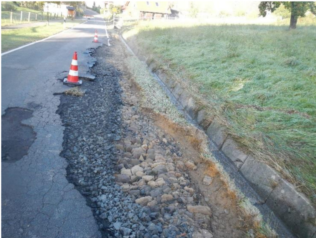
Abbildung 59: Durch Starkregen unterspülte Straße (Beispielbild)
