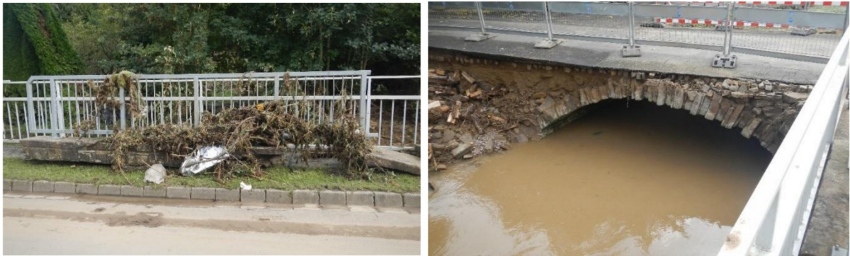
Abbildung 63: Treibgut und zerstörtes Brückengeländer infolge Wasserdrucks (Beispielbilder)
