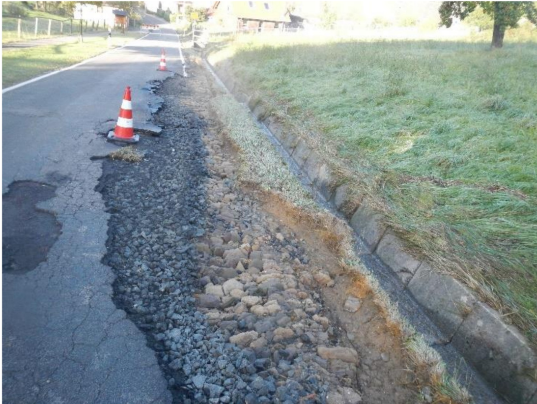
Abbildung 67: Durch Starkregen unterspülte Straße (Beispielbild)
