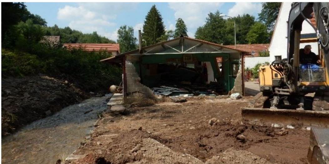
Abbildung 64: Eingestürzte Wand infolge Wasserdrucks (Beispielbild)
