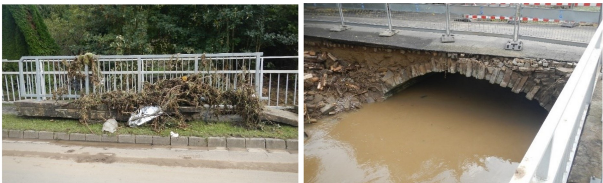
Abbildung 52: Treibgut und zerstörtes Brückengeländer infolge Wasserdrucks (Beispielbilder)
