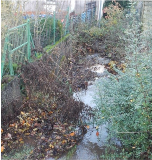
Abbildung 39: Vegetation und Ablagerungen im Gewässerabschnitt nach dem Durchlass
