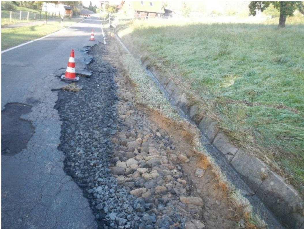
Abbildung 56: Durch Starkregen unterspülte Straße (Beispielbild)
