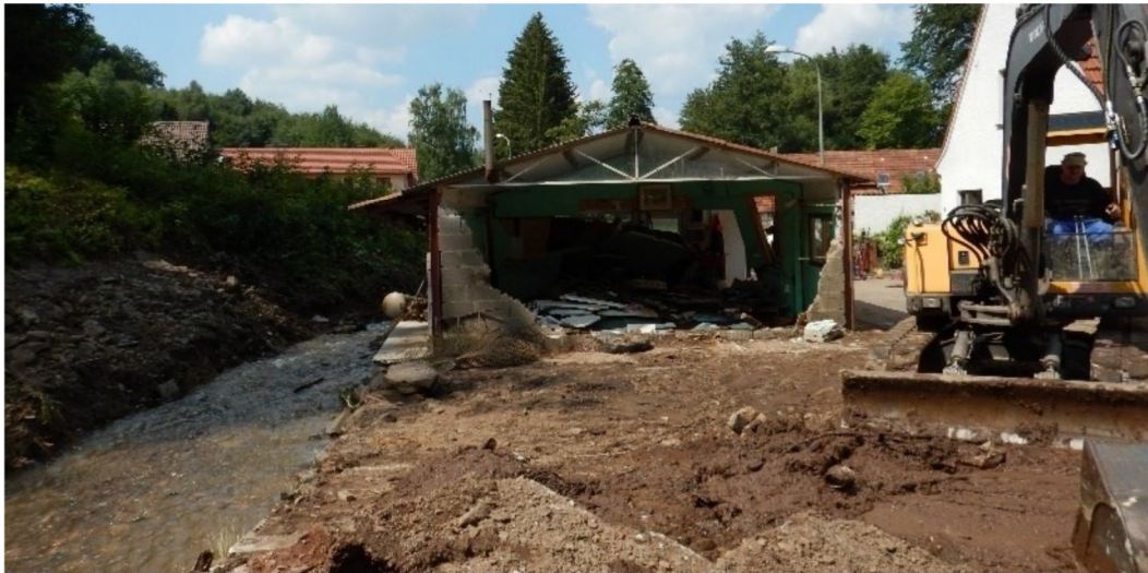
Abbildung 53: Eingestürzte Wand infolge Wasserdrucks (Beispielbild)
