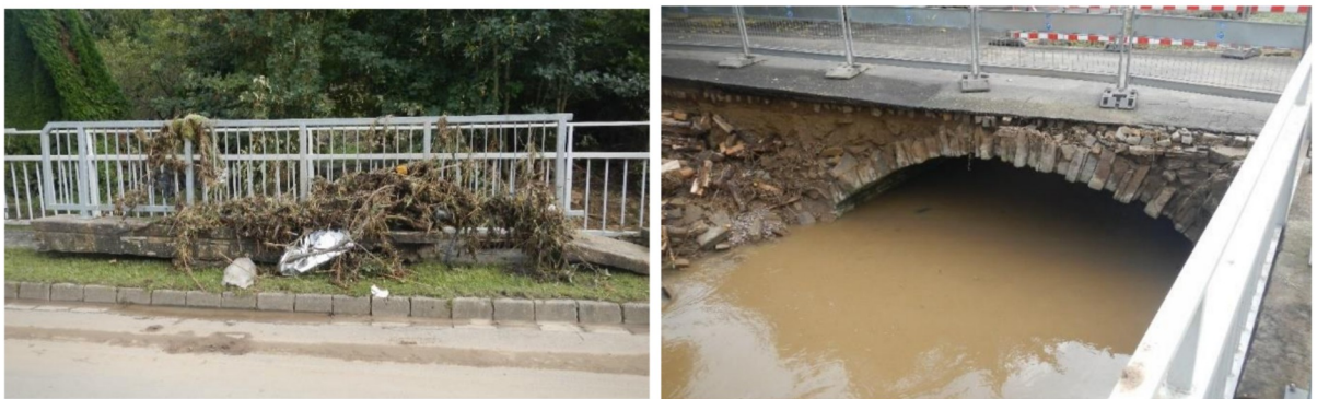
Abbildung 64: Treibgut und zerstörtes Brückengeländer infolge Wasserdrucks (Beispielbilder)
