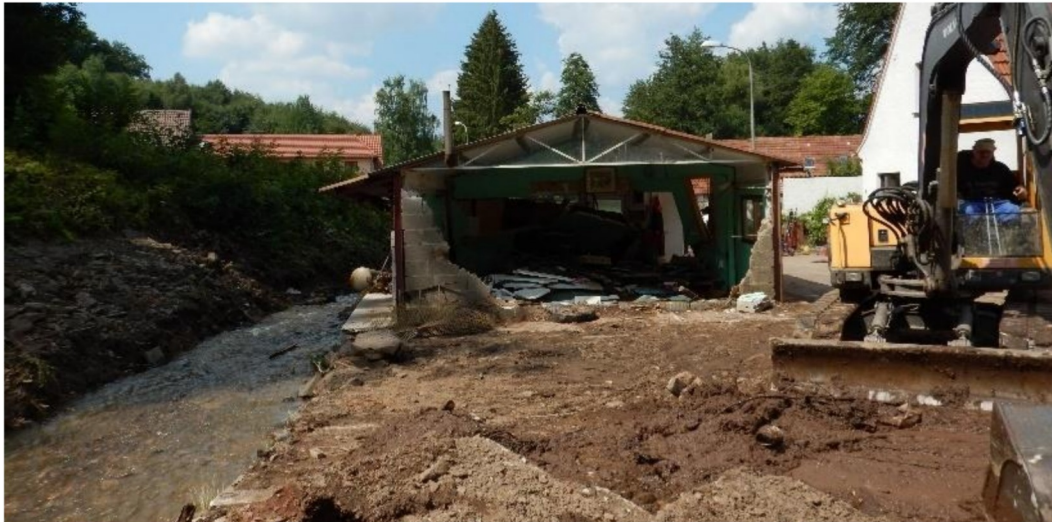
Abbildung 65: Eingestürzte Wand infolge Wasserdrucks (Beispielbild)
