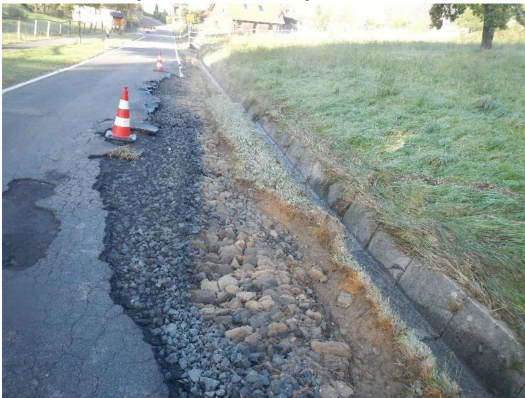
Abbildung 68: Durch Starkregen unterspülte Straße (Beispielbild)
