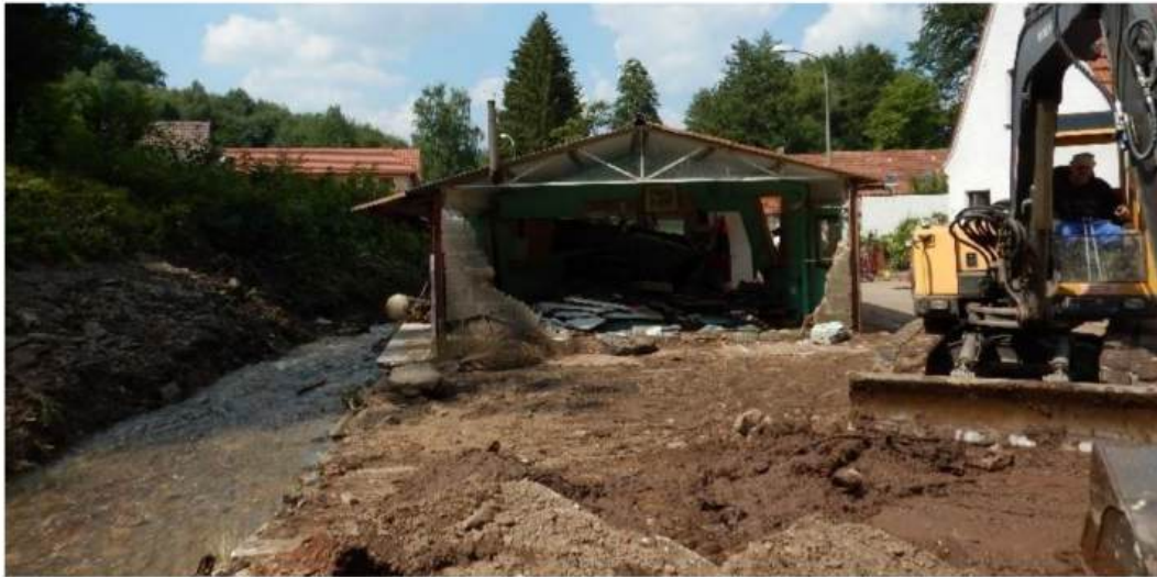
Abbildung 163: Eingestürzte Wand infolge Wasserdrucks (Beispielbild)
