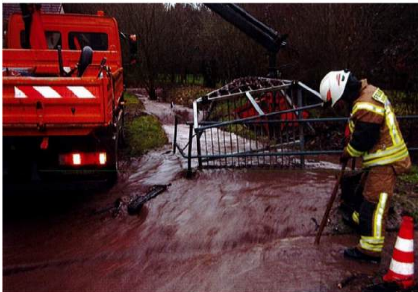
Abbildung 93: Hydraulische Überlastung der Verrohrung bei Starkregen
