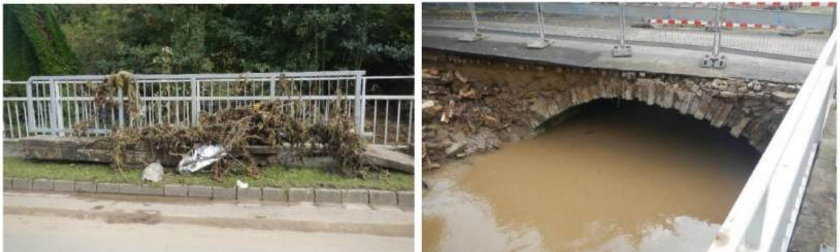
Abbildung 162: Treibgut und zerstörtes Brückengeländer infolge Wasserdrucks (Beispielbilder)
