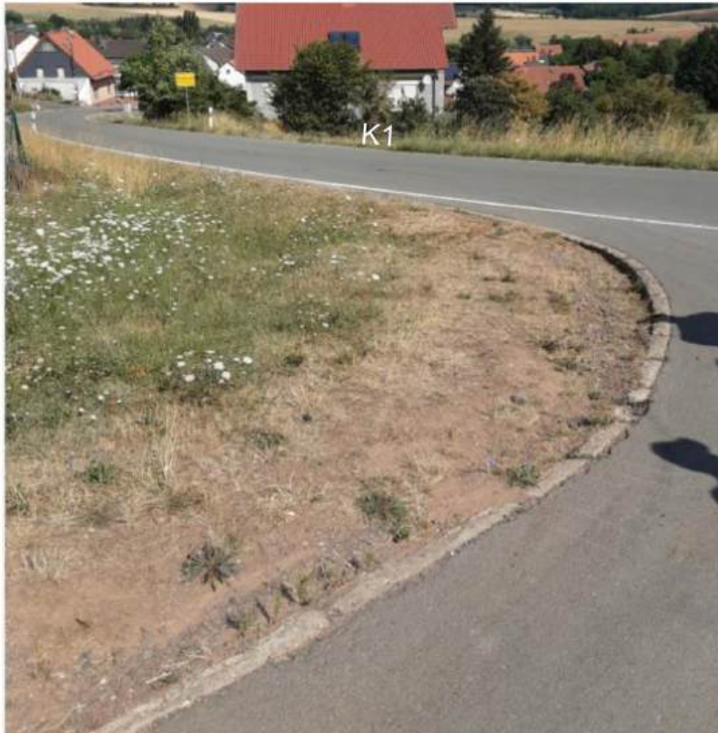
Abbildung 72: Erosion Feldweg, K1
