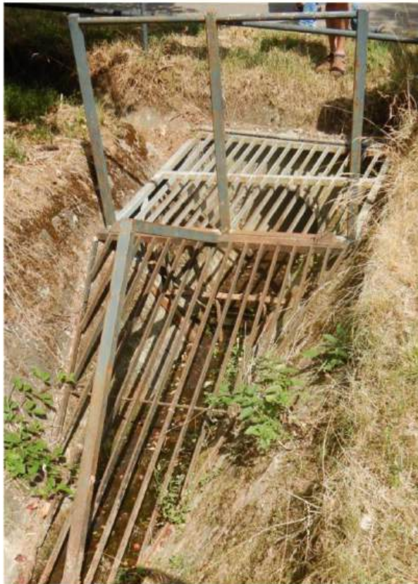
Abbildung 92: Anfang der Verrohrung des Thronbach und Treibgutfänger
