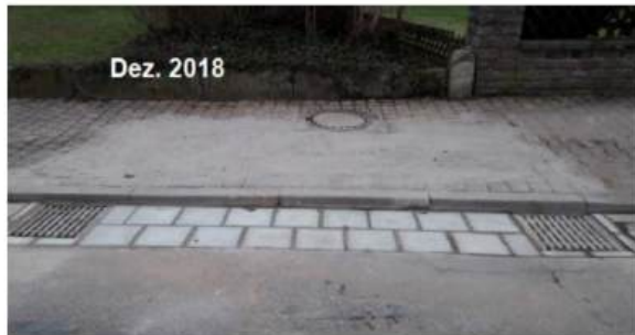
Abbildung 148: Zusätzliche Straßeneinläufe, Wäschbacherhof
