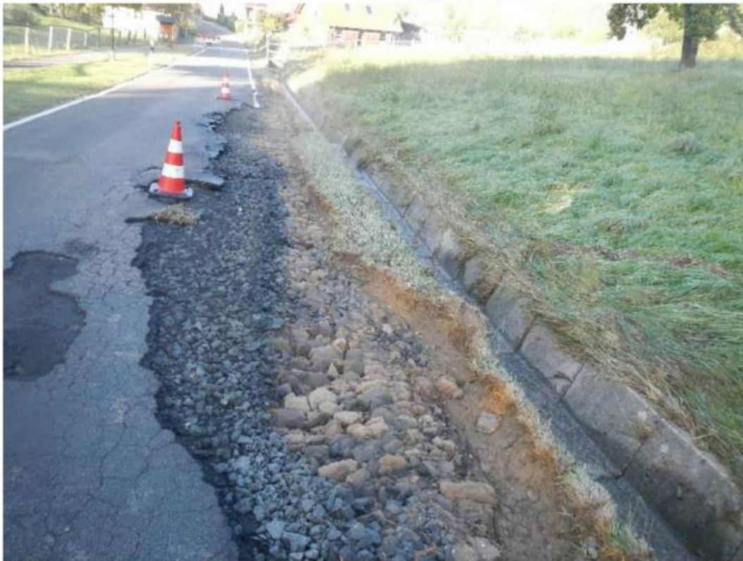
Abbildung 166: Durch Starkregen unterspülte Straße (Beispielbild)
