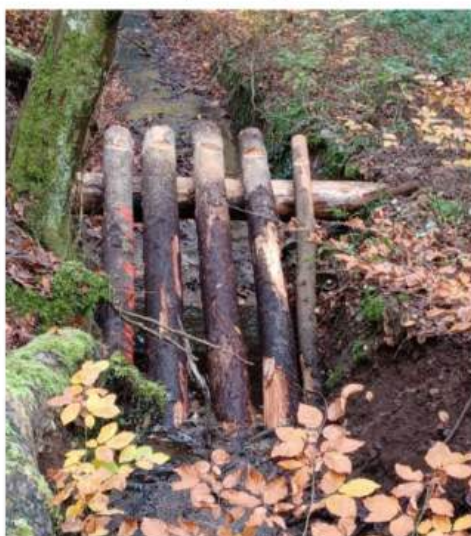
Abbildung 100: Treibgutfänger im Gewässer
