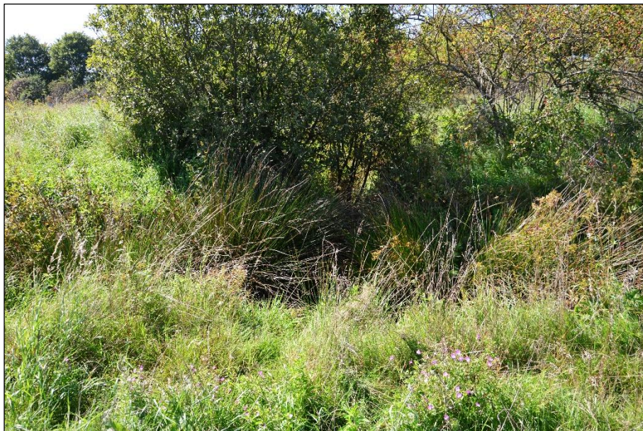
Abb. 15: V-förmiger Einschnitt in bestehendem Damm, welcher aktuell durch Vegetationsbedeckung verlangsamt wird (Quelle: UP&B)
