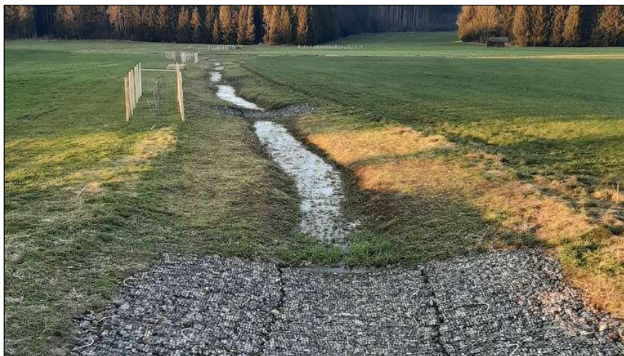
Abb. 21: Verzögerung der Abflussgeschwindigkeit entlang einer begrünten Abflusssrinne mittels Einbau von Steinmatratzen (Quelle: OVB 2023)
