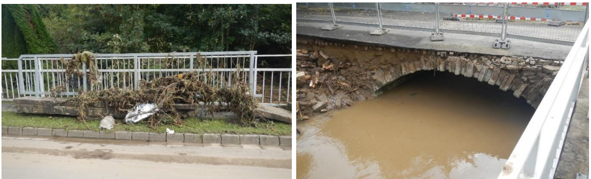
Abbildung 55: Treibgut und zerstörtes Brückengeländer infolge Wasserdrucks (Beispielbilder)
