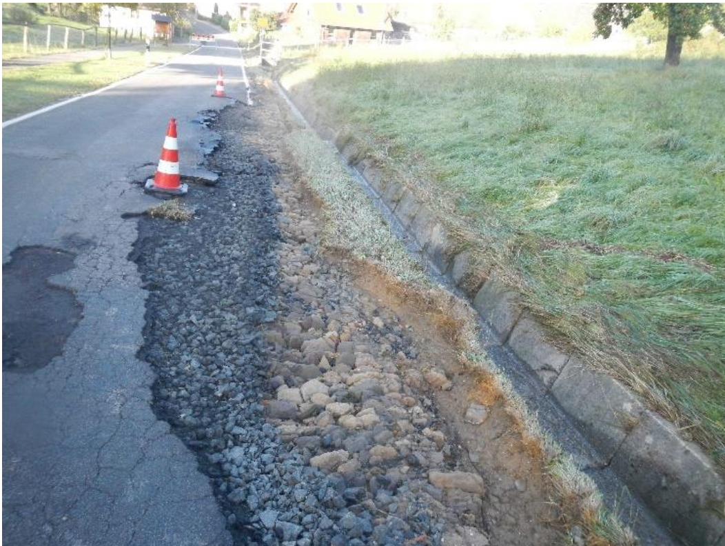
Abbildung 59: Durch Starkregen unterspülte Straße (Beispielbild)
