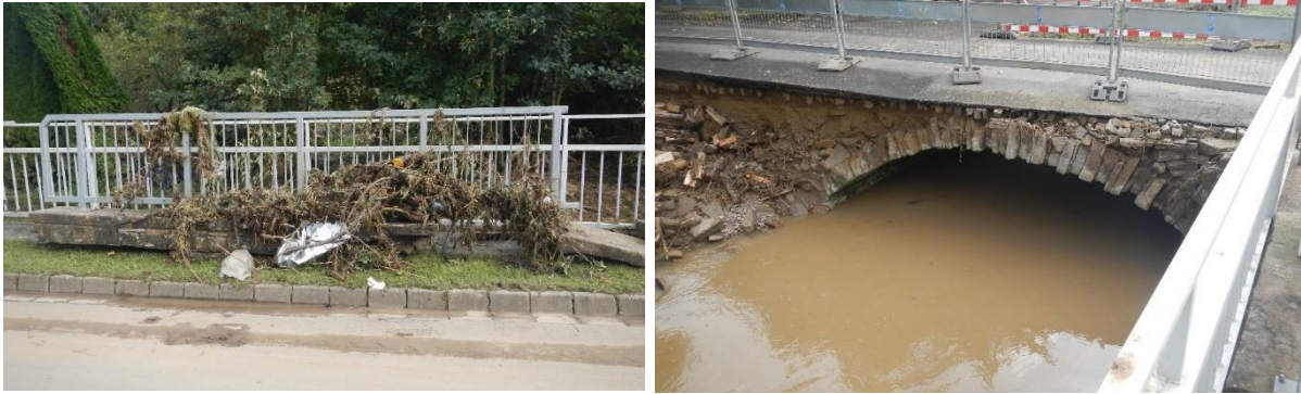
Abbildung 63: Treibgut und zerstörtes Brückengeländer infolge Wasserdrucks (Beispielbilder)
