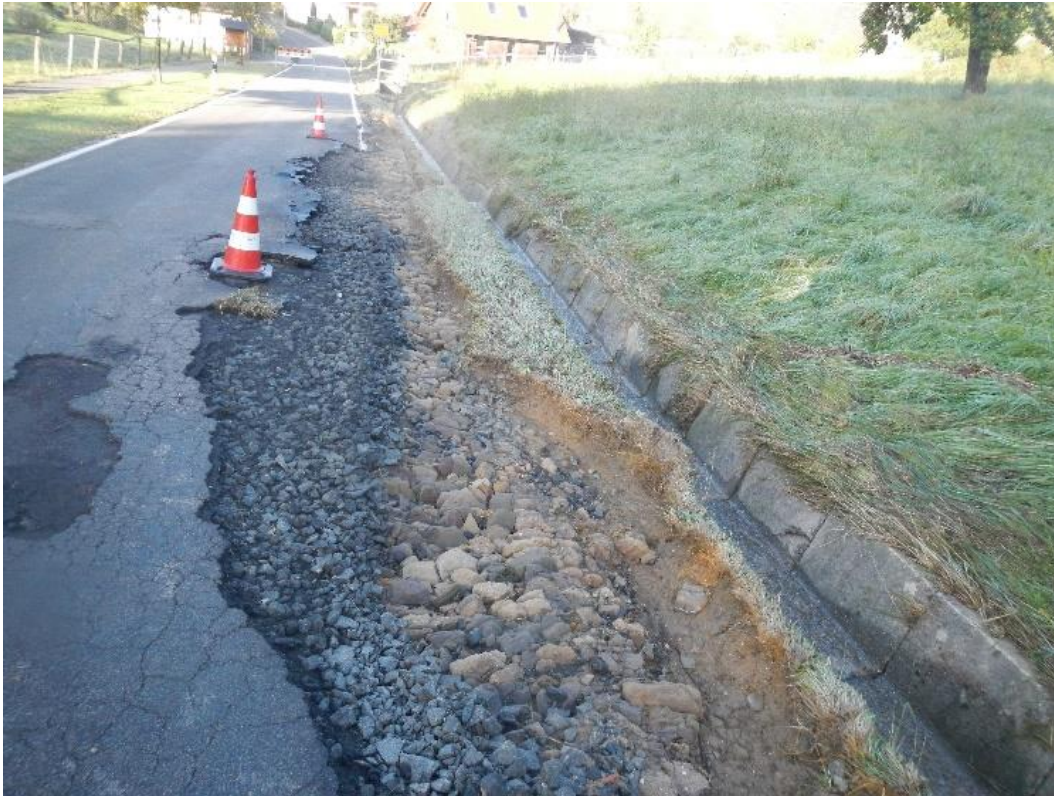
Abbildung 67: Durch Starkregen unterspülte Straße (Beispielbild)
