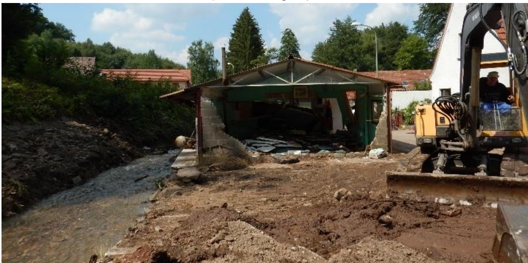
Abbildung 64: Eingestürzte Wand infolge Wasserdrucks (Beispielbild)
