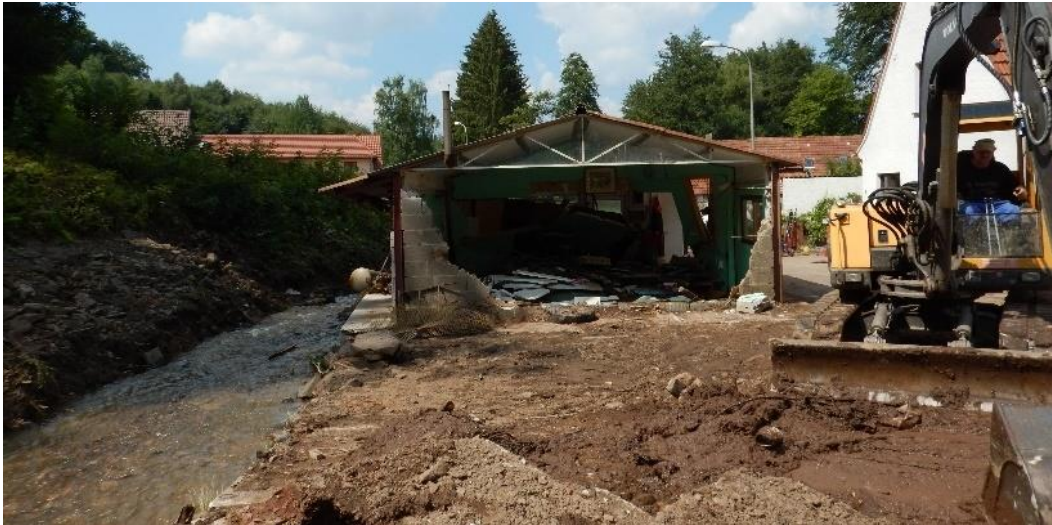
Abbildung 65: Eingestürzte Wand infolge Wasserdrucks (Beispielbild)
