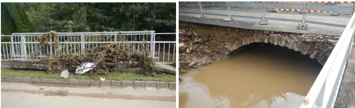
Abbildung 64: Treibgut und zerstörtes Brückengeländer infolge Wasserdrucks (Beispielbilder)
