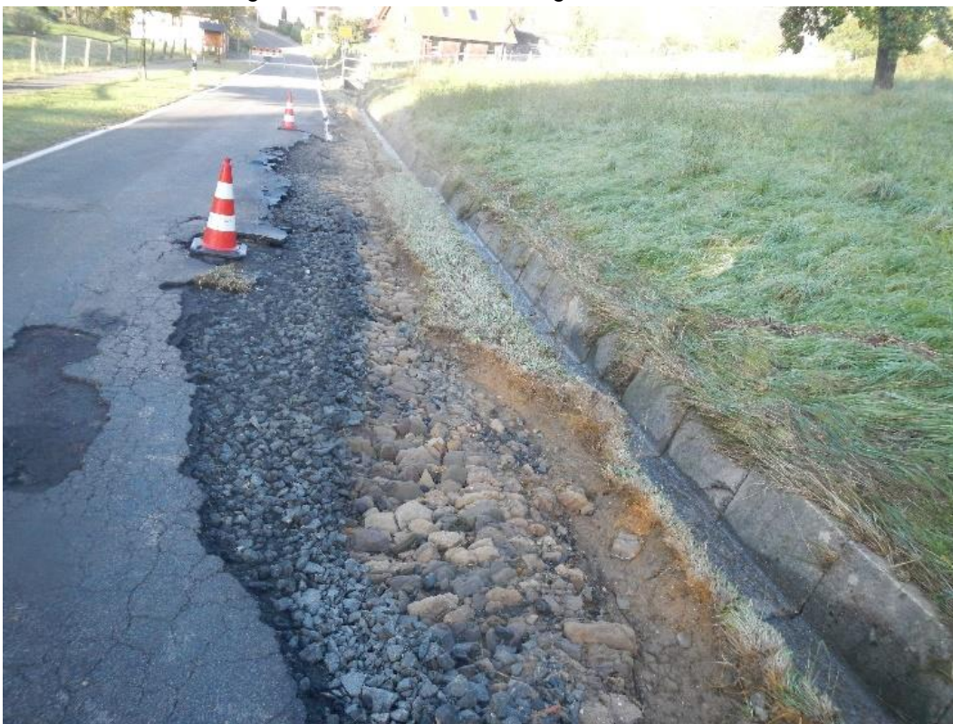
Abbildung 68: Durch Starkregen unterspülte Straße (Beispielbild)
