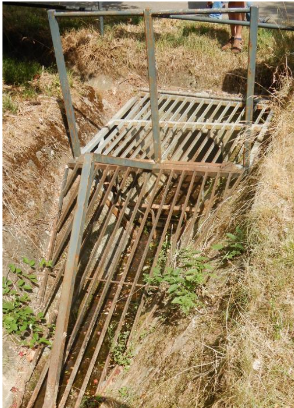
Abbildung 92: Anfang der Verrohrung des Thronbach und Treibgutfänger
