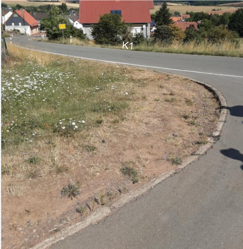
Abbildung 72: Erosion Feldweg, K1
