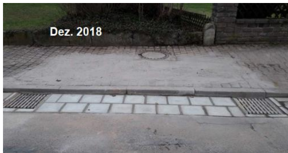
Abbildung 148: Zusätzliche Straßeneinläufe, Wäscherhof
