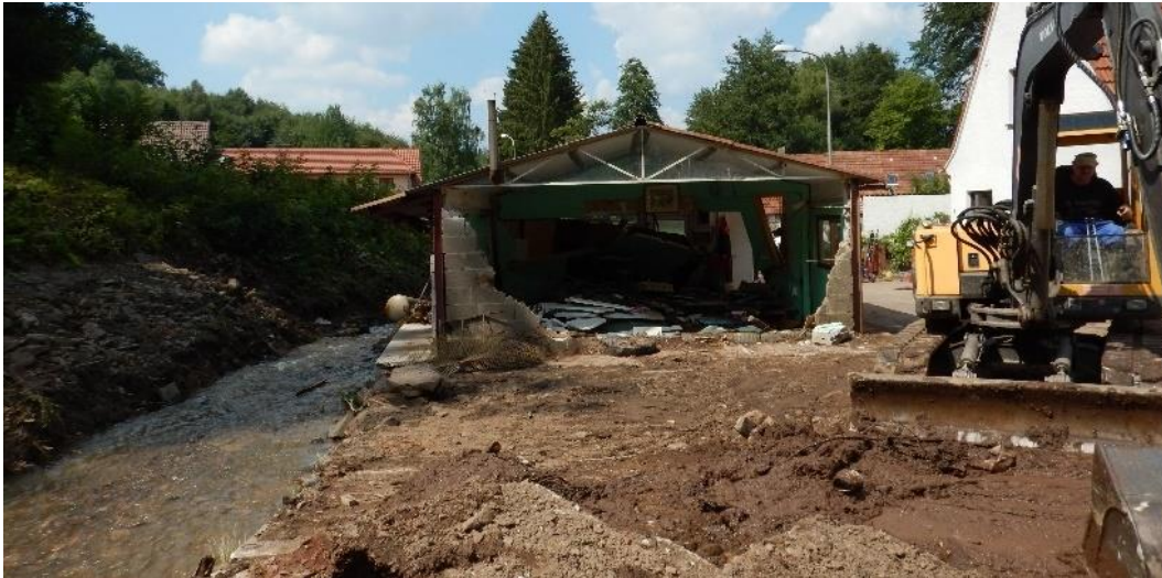
Abbildung 163: Eingestürzte Wand infolge Wasserdrucks (Beispielbild)
