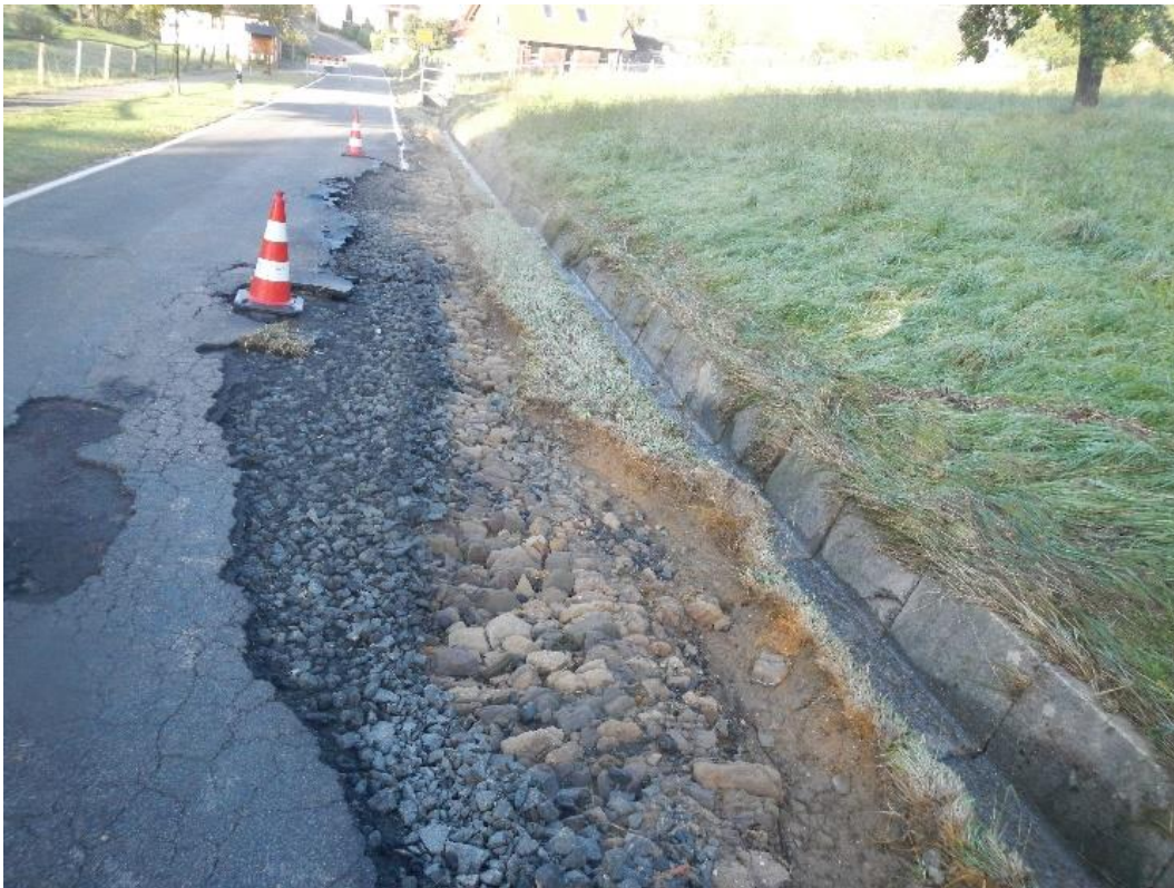
Abbildung 166: Durch Starkregen unterspülte Straße (Beispielbild)
