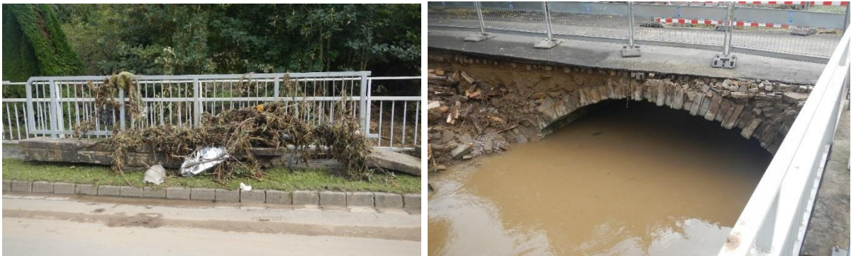
Abbildung 162: Treibgut und zerstörtes Brückengeländer infolge Wasserdrucks (Beispielbilder)
