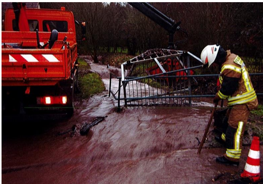
Abbildung 93: Hydraulische Überlastung der Verrohrung bei Starkregen
